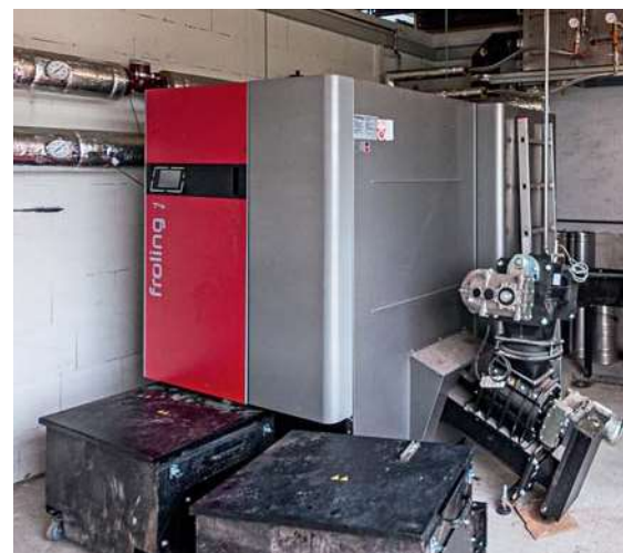
Neue Heizungsanlage bei Rosen Escher
