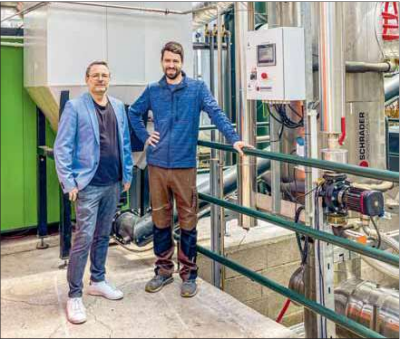
Jörg Schwidrowski (Schröder Abgastechnologie) und Lukas Weilbrenner vor der neuen Anlage.
