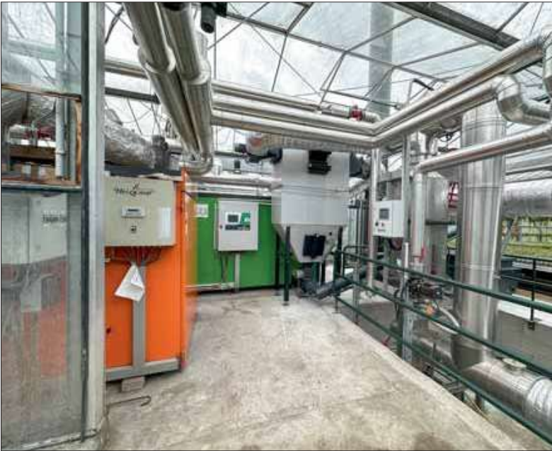
Die Hackschnitzel-Anlage samt Wärmerückgewinnung. Für den Wärmetauscher wurde eigens eine Vertiefung geschaffen. Foto: Heizomat
