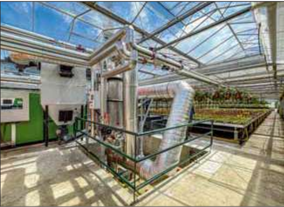
Die Anlage wurde ins Gewächshaus integriert, ihre (Ab-) Wärme wird unmittelbar genutzt.
