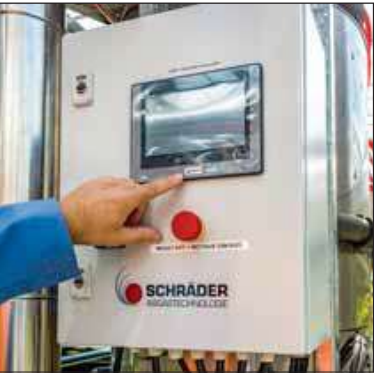
Einfach in der Handhabung: die Regelung des Abgaswärmetauschers
