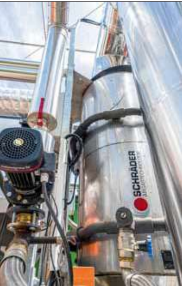
Der imposante Wärmetauscher „Thermtube 9 x 900 Condens“ von Schröder nutzt die Abwärme des Heizkessels zur Anhebung der Rücklauftemperatur.
