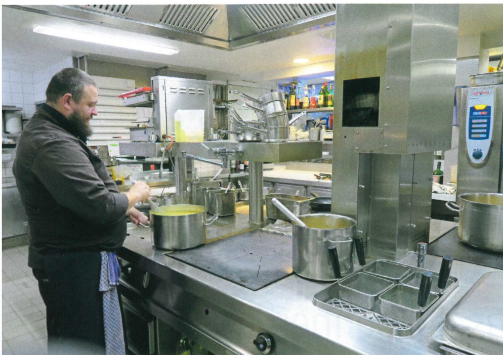
Die Abwärme aus der Küchenherdanlage wird mittels Wärmerückgewinnung dem Pufferspeicher für die Trinkwassererwärmung zur Verfügung gestellt.
